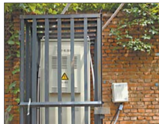
信号塔旁边的室外电源柜。
