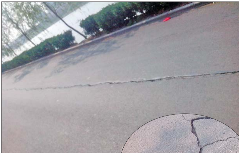
▲腊山分洪防汛道路被轧坏出现很长的裂缝。
