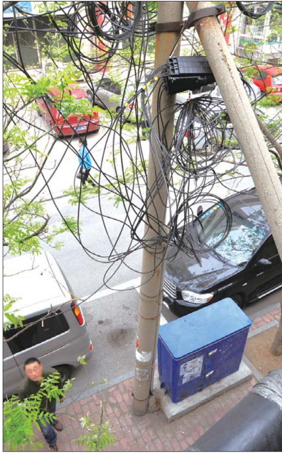
上齐西路附近,长城宽带的基站设在广电的线杆旁,电缆也缠在了线杆上。见习记者 吕奇 摄
