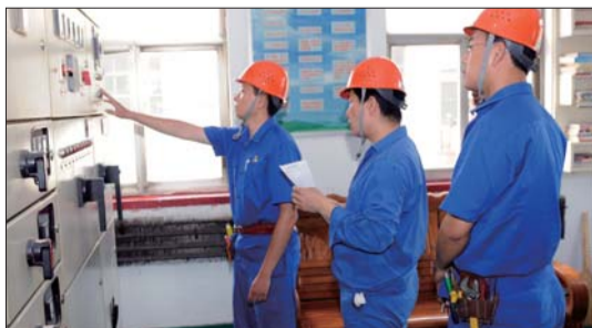
供水演练,工作人员根据来水水量开启机组。
