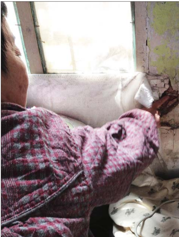
下过几天雨之后,于女士家的墙壁一碰就往下掉墙皮。
