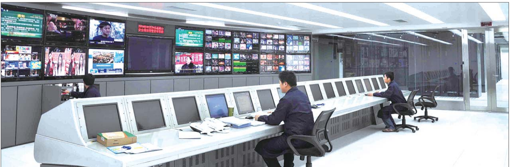
日照广电网络的现代化数字机房。
