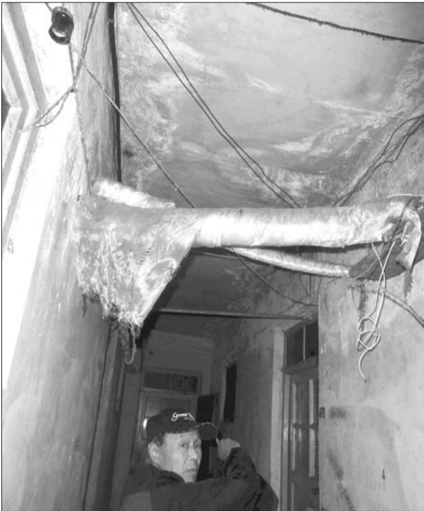
在2楼与3楼间的隔层,还留着渗水造成的痕迹。本报记者王敏 摄
