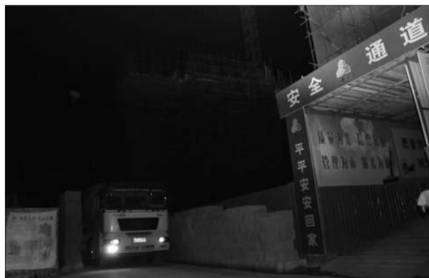
张店橡树湾小区建筑工地夜间违规施工被责令停止。 本报记者 王鸿哲 摄
