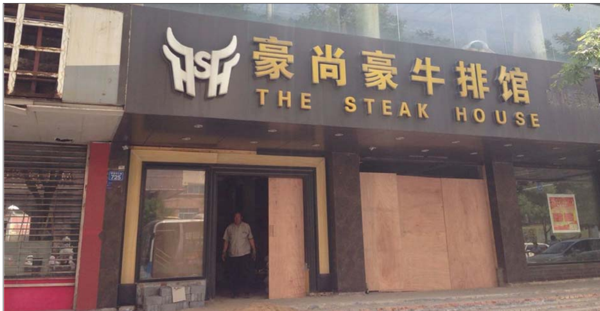
新店面正在重新装修。 本报记者 贺莹莹 见习记者 杜彩霞 摄
