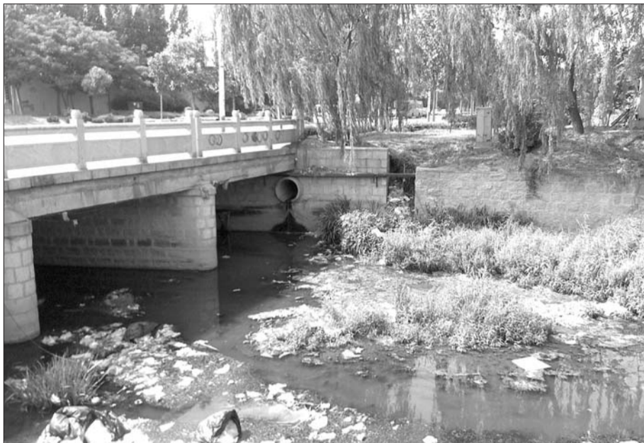
福新路柳子河桥下垃圾成堆, 雨水口还在往外排污水。 本报记者 修雪皎 摄
