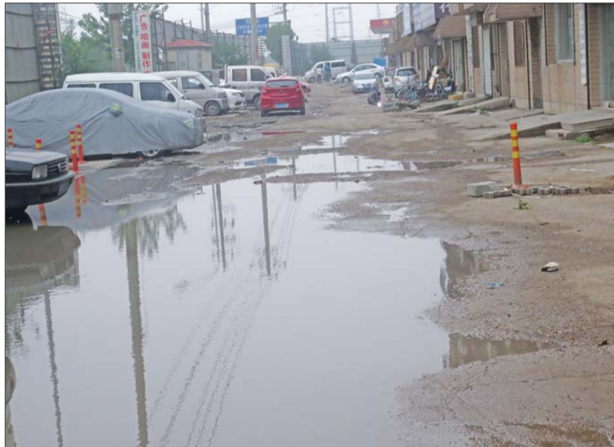
舜清苑小区北区,门前污水给居民造成困扰。
