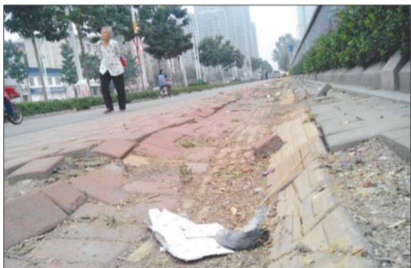
花园路北首路东约50米的人行道、盲道塌陷。行人路过此处一般都在非机动车道上行走。周围一居民说塌陷已有三四个月了,希望尽快修复。本报见习记者 闫克航 摄
