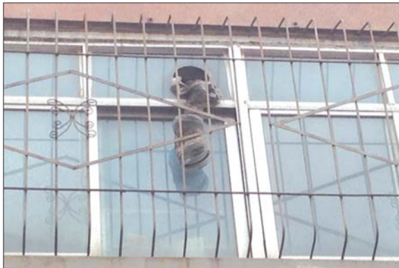
厨房的油烟机管道烧化。本报记者 邢志彬 摄
