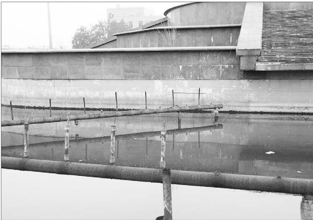
光明广场喷泉管道生锈严重。本报记者 韩微 摄
