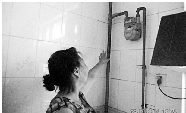
15年的燃气管道已经锈蚀。本报记者 公素云 摄
