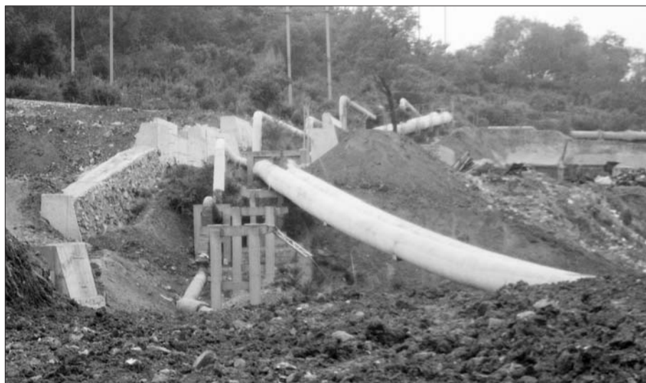
塌方区域, 有两条供暖管道和一条蒸汽管道断裂, 破坏长度达80米。 本报记者 柳斌 摄
