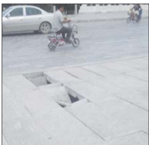
运河桥上断裂的石板。 本报记者 郭庆文 摄
