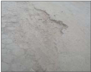
民主小学门口路面损坏严重。 本报记者 郭庆文 摄
