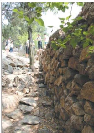
穆柯寨残存的围墙,已经只剩残垣断壁。
