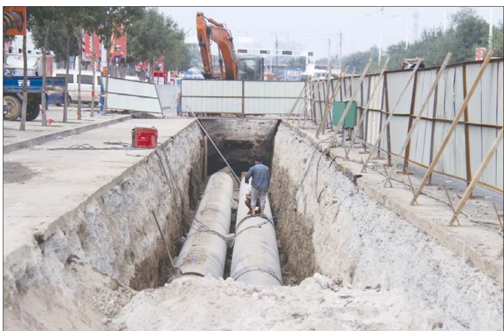
在青年路西首,施工人员在铺设通往铁西小锅市的供热管道。 本报记者 王小会 摄
