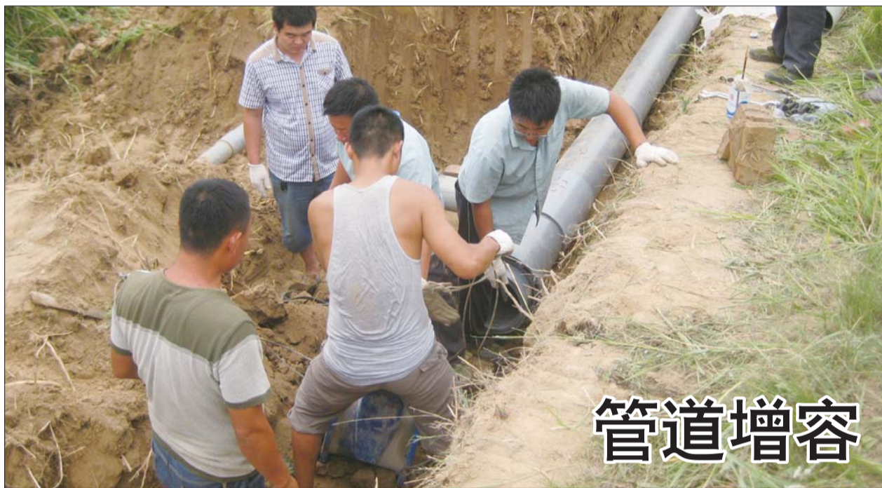
日前,无棣县自来水农村供水总公司顶着烈日维护管道,确保农村供水保障。无棣县三角洼水厂肩负着全县8个多乡镇农村的供水任务,管线长,工作量较大,供水管道经常遭遇破坏,不管条件多么恶劣,维修人员都会第一时间赶赴现场进行维护。图为农村管网埋口段改造扩容工程进行中。
