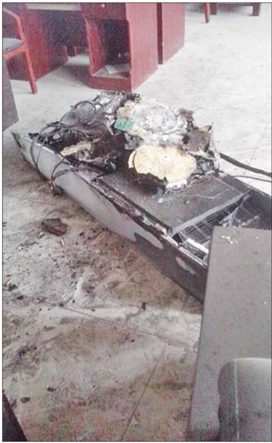
杜先生提供的自燃空调图片。
