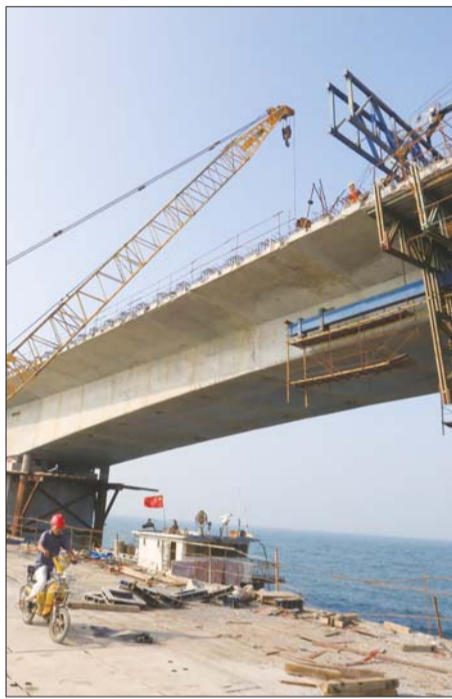
长岛南北长山大桥正在加紧施工,今天凌晨合龙,10月1日正式通车。通讯员供图
