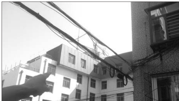
光缆从居民李先生家的窗户底下穿过。本报记者 尹海涛 摄
