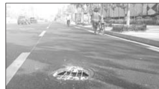
23日,位于南大街御金台站点附近的井盖破损露出钢筋。本报记者 蒋大伟 摄
