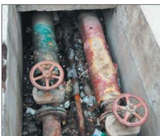
化纤小区内的供暖设施破旧不堪,也需要改造。
