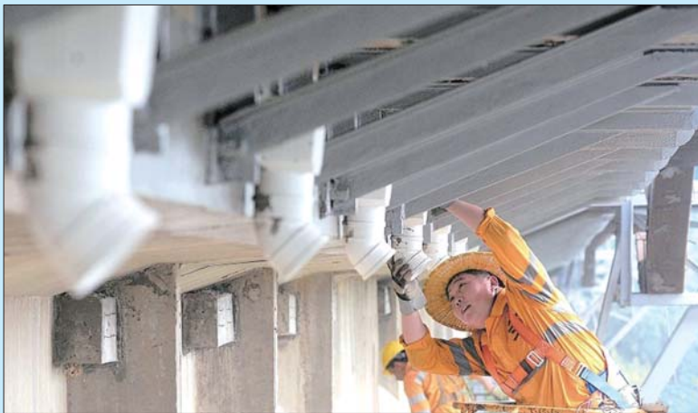
近日,济铁聊城工务段职工为京九铁路孙口黄河特大桥安装滴水檐排水孔接长装置,延长桥梁混凝土使用寿命。 济南铁路局微博 供图
