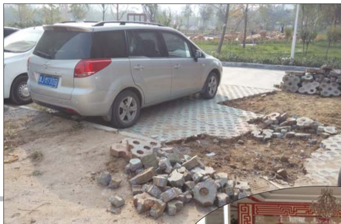
道路旁的停车位被扒掉。
