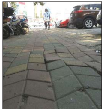
摔伤市民的路面凹凸不平多日没有修复。本报记者 赵兴超 摄
