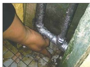
唐先生说,漏水点在管道最底部,修过几次都没修好。本报记者 张倩倩 摄
