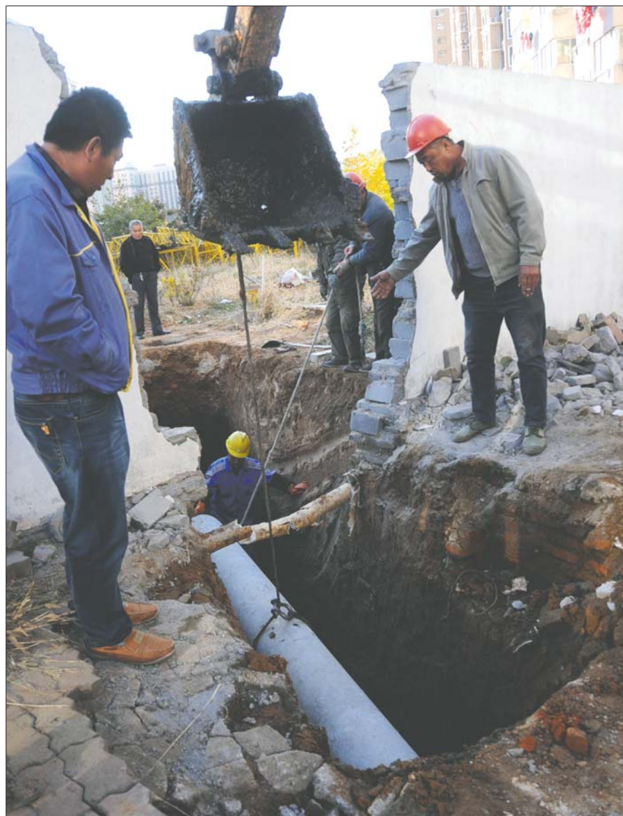
6日下午,施工人员正在现场更换下水管道。本报记者 李泊静 摄
