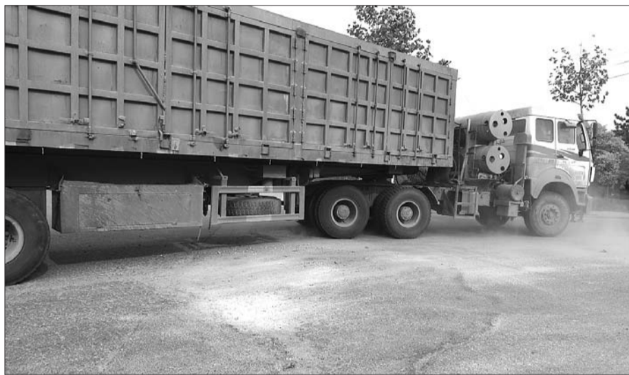
每天有大量挂车、货车经过秀林路,已有多处路面被轧坏。 本报记者 张倩倩 摄
