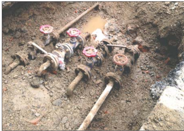
工作人员挖开路面,准备焊上破碎的供暖管道。 本报记者 朱文朋 摄
