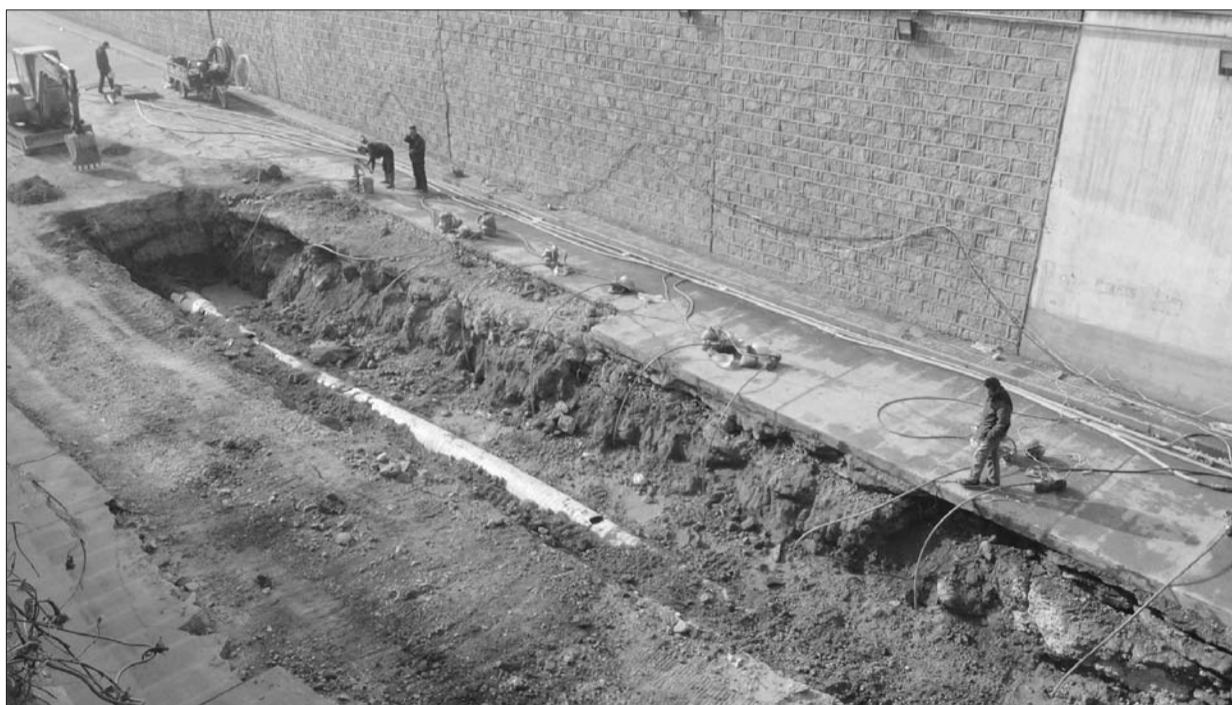
商贸大道塌陷部位已凿开,工作人员清理淤泥。徐良 摄
