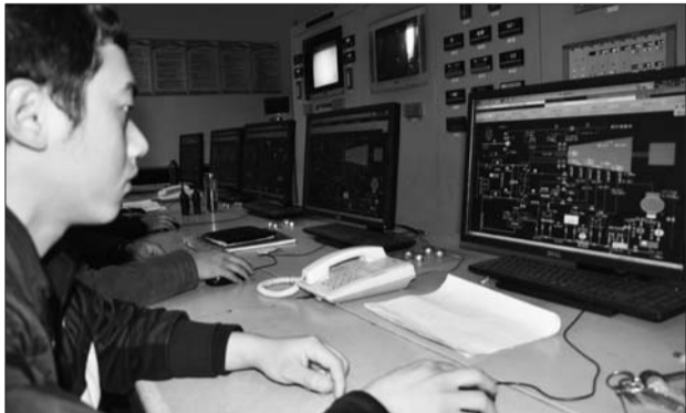
机炉主控室相当于系统的大脑,哪个地方出现问题,都要在这调控。
