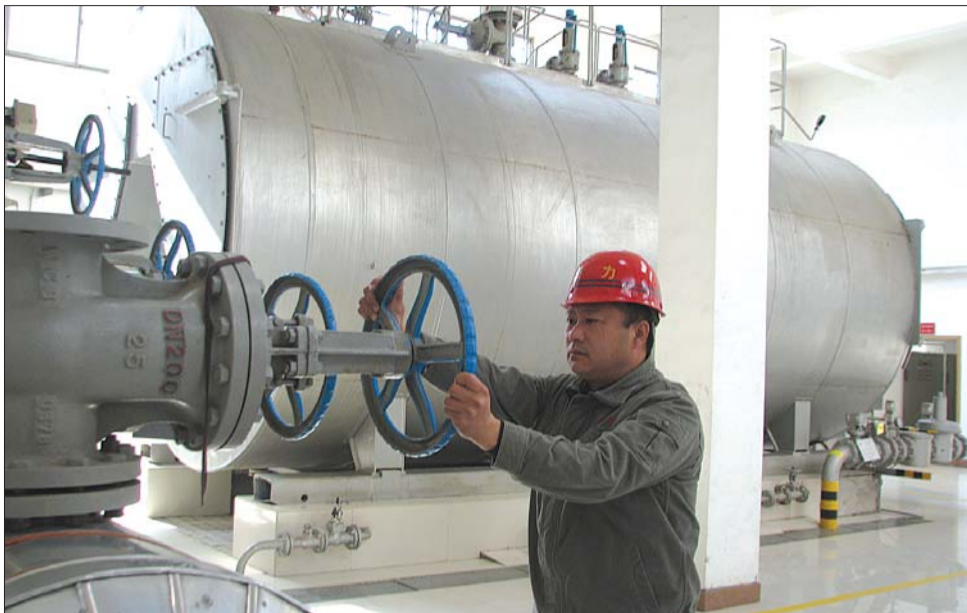
在天外村换热站,工作人员调试设备。
