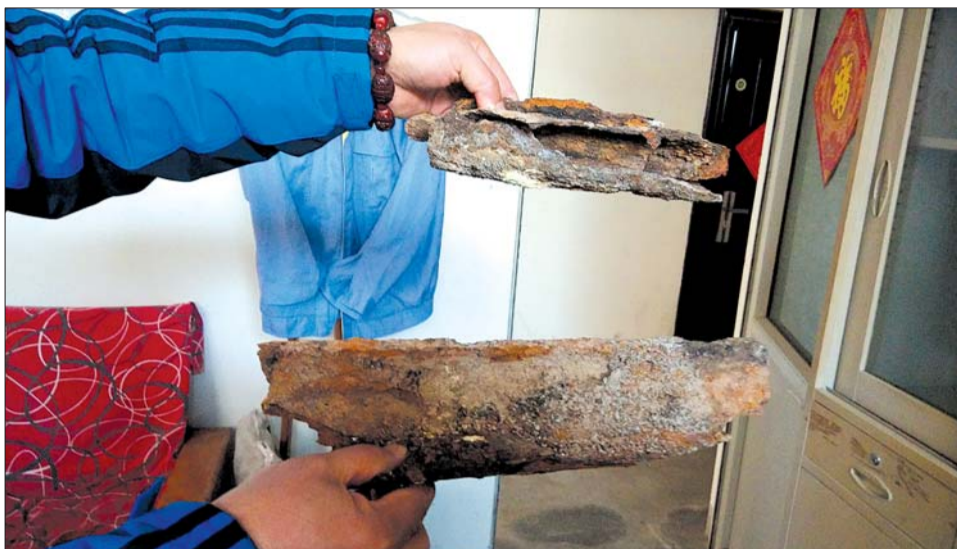
化纤小区被挖出和更换的管网已经锈迹斑斑。 本报记者 蒋龙龙 摄
