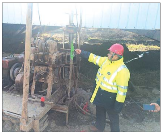
现场的钻孔已经做好密封,并用水泥砂浆回填。 本报记者 喻雯 摄
