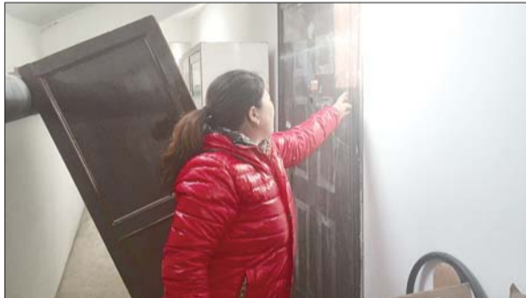
曲女士说,自己楼上的阁楼被打通安装了防盗门。 本报记者 柳斌 摄
