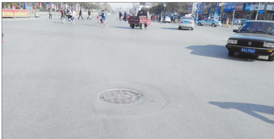
在花园路和洪楼南路交叉路口,不少三防井盖周边已低于路面。 本报记者 王皇 摄
