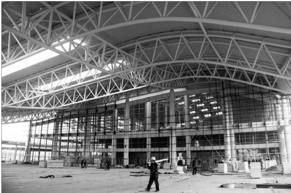
12月7日下午,德州综合客运站内工作人员正在安装候车区与发车区之间的玻璃隔断。 本报记者 王小会 摄
