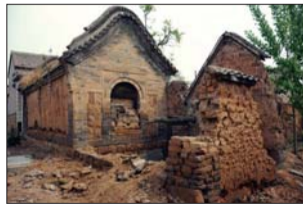
玉清堂前厅坍塌。
