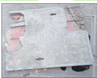
常外溢的下水道口井盖已经破损。
