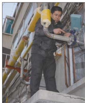
工作人员调试供热设备。贺莹莹 摄
