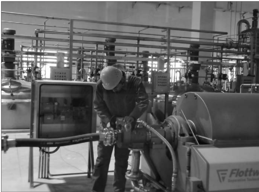
膳食纤维提取项目部分生产设备。
