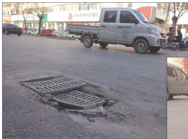
19日,本报曾报道财源大街和校场街中段七处公交站前井盖破损严重,有的已丢失。22日,市政部门排水管网所紧急修复受损井盖。本报记者 赵兴超 摄影报道
