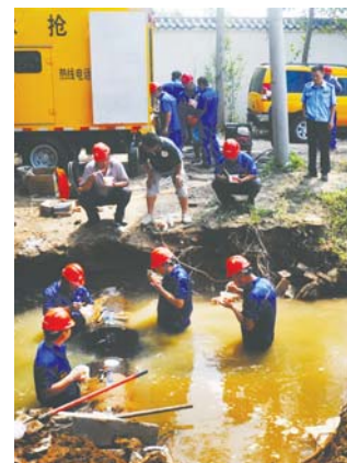
8月21日,供水主管被意外挖断,全城停水,抢修中工作人员匆匆解决午餐。
