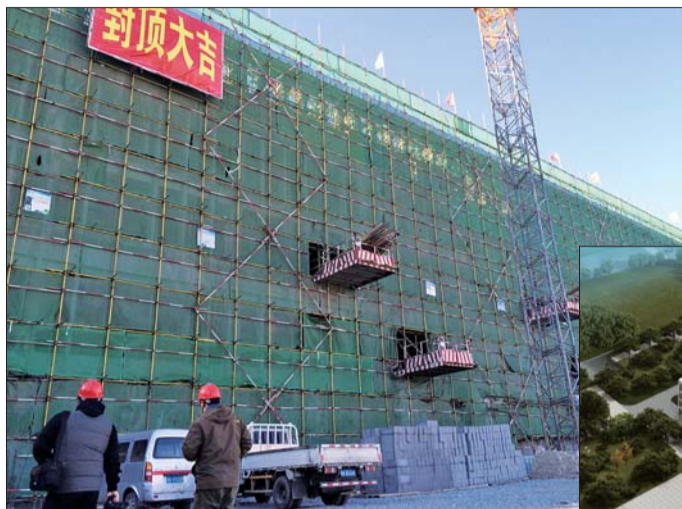
由于周边紧邻居民区、幼儿园,夜间不能施工,施工人员只得采用静态爆破施工。加上冬日下雪较频繁,施工人员最终抢工,仅用2个月的时间完成主体封顶。该停车楼预计今年5月达到
