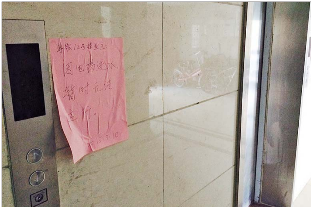
▲电梯口贴着手写的电梯停运通知。
