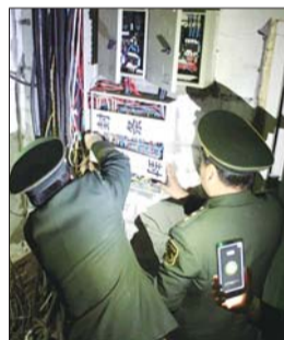
消防执法人员在超市配电盘处张贴封条。
