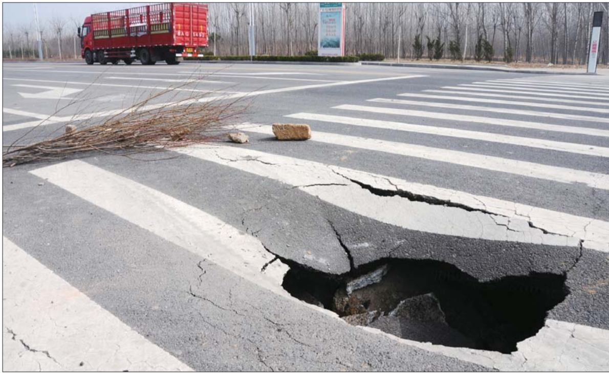
坑内数米宽的范围已完全悬空,仅靠路面支撑。本报记者 马志勇 摄
