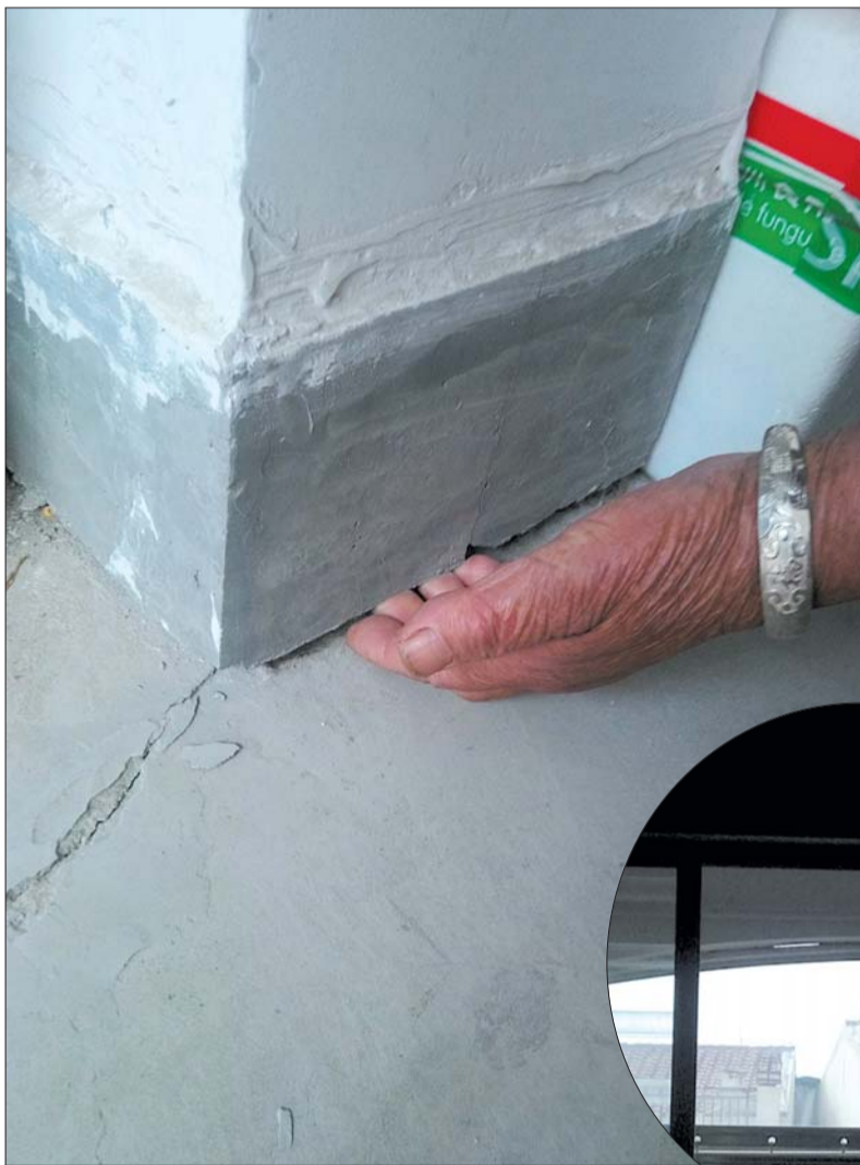
▲地面与承重柱之间的裂痕。
