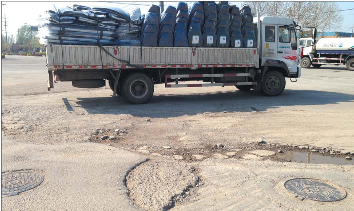
▲路口处存在多处坑洼。
