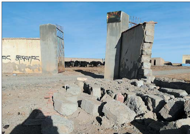
黄河源小学今年没招学生,校门口的围墙已经倒塌。
